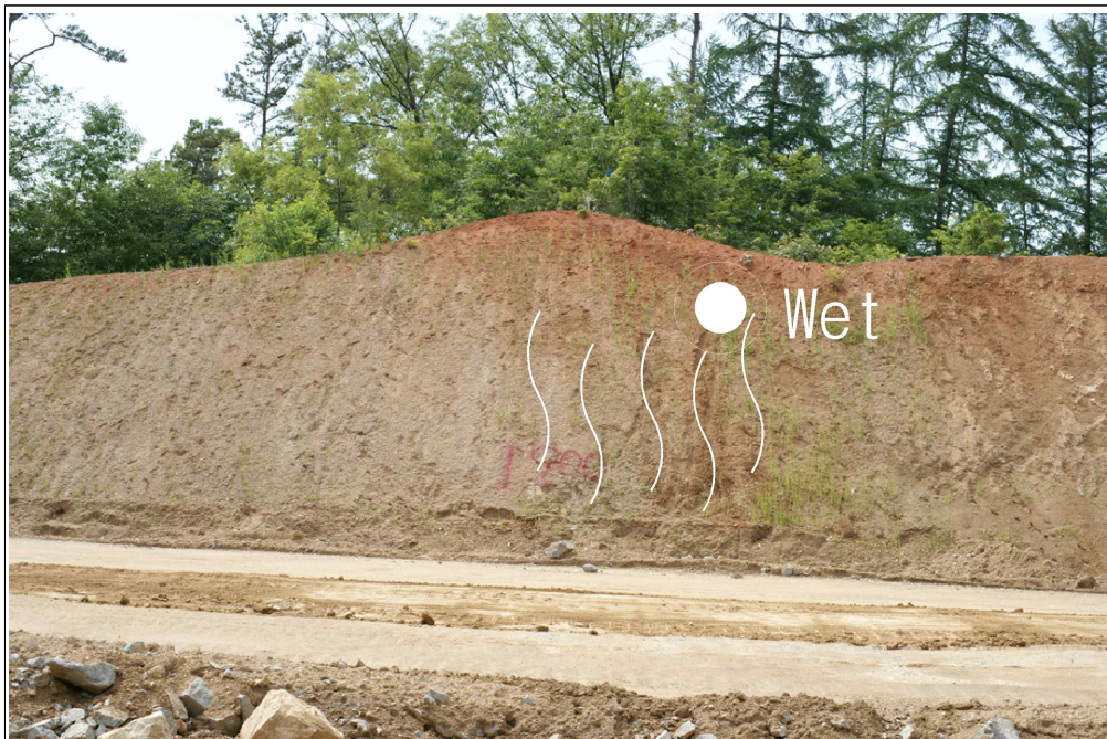
【그림 9】 A 영역 상세사진 (지하수 유출 및 토사유실)
