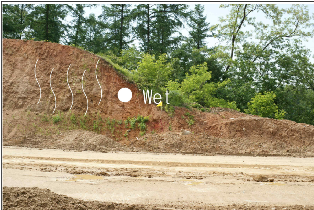
【그림 11】 A 영역 상세사진 (지하수 유출 및 토사유실)
